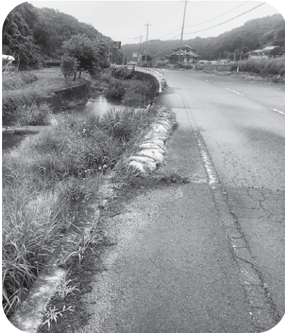
はんらん 氾濫箇所の整備を急げ
