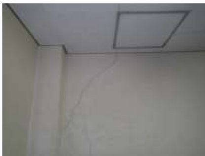
■内壁面の亀裂（本庁舎）
