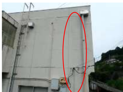
■外壁面の亀裂（本庁舎）
