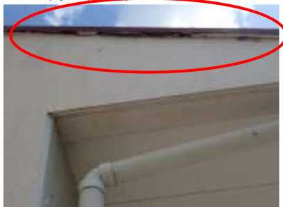
■ 金属屋根の劣化
