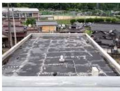
■屋上防水層の劣化（本庁舎）
