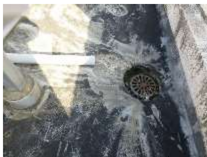
■屋上防水層の劣化（本庁舎）
