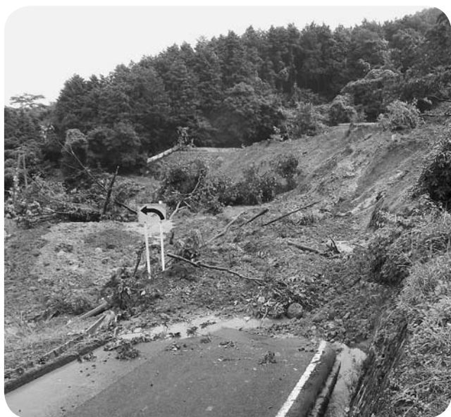
台風12号で寸断された町道 休札小山上線災害現場(上口地内)
