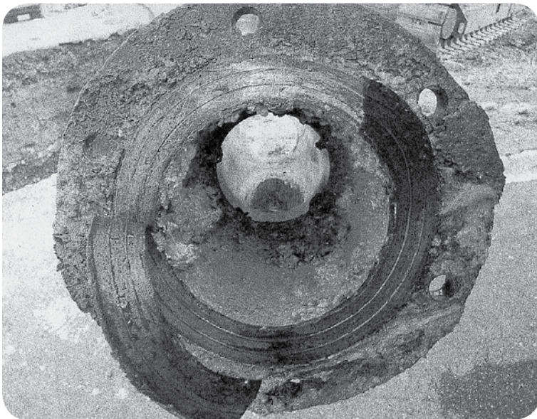
古くなった水道管
