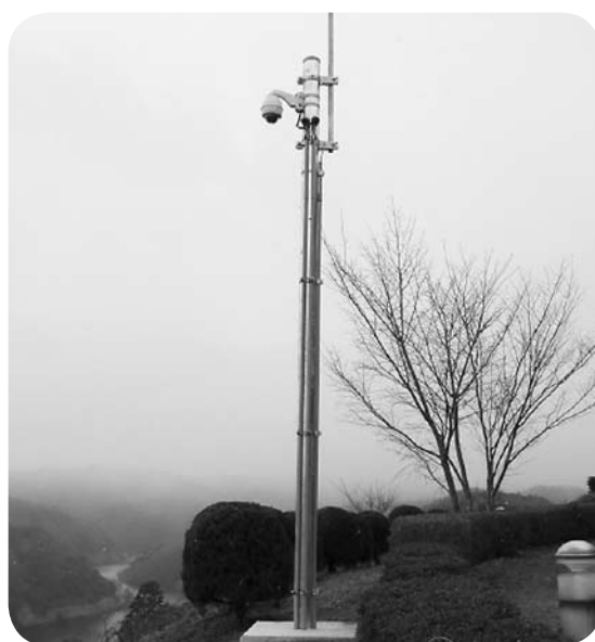
新設された防災カメラ（三休公園）
