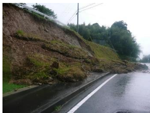
道路法面被災状況
