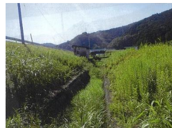
土砂取り除き前
